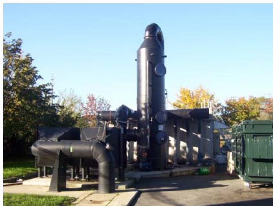
Triel sur Seine : lavage des gaz + biofiltre
